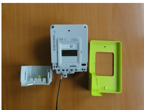
Figure 5 : compteur Linky ouvert faisant apparaître le bornier
